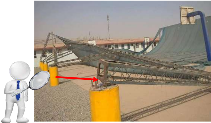
Figura N.º 82: Colapso de anclaje
