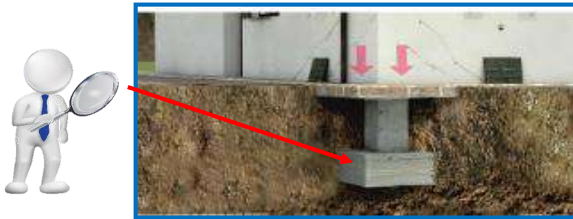
Figura N.º 21: Cimentación expuesta
