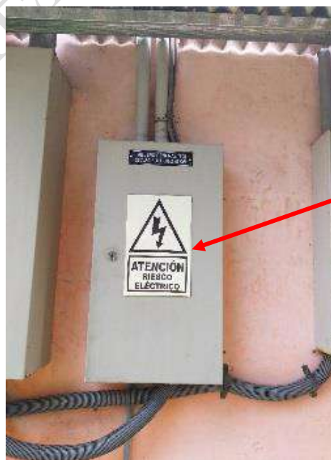
Figura N.º 208: Tablero general con señalización de seguridad de riesgo eléctrico en la tapa
