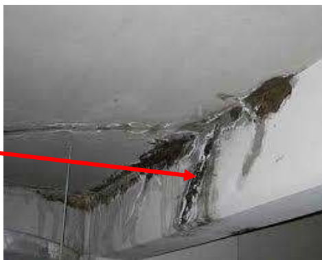
Figura N.º 43: Viga de concreto con deterioro presenta por humedad
