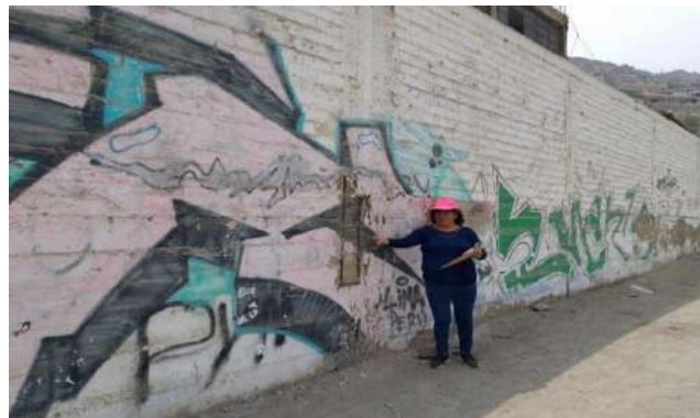
Figura N.º 99: Cerco perimétrico de ladrillo con varillas de acero expuestas a la intemperie
