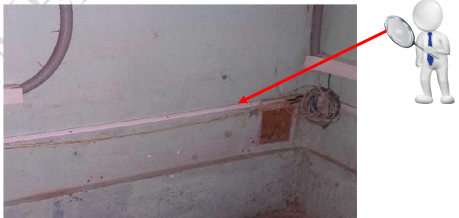
Figura N.º 199: Conductores eléctricos protegidos con canaletas de PVC
