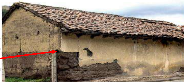
Figura N.º 74: Encuentros de muro de adobe presentan amarres inadecuados
