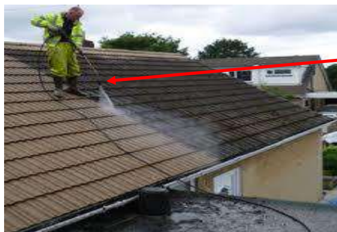
Figura N.º 186: Verificación del sistema de drenaje mediante surtimiento de agua con manguera
