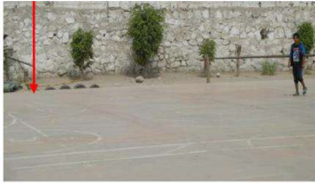
Figura N.º 57: Muro de contención con grietas
