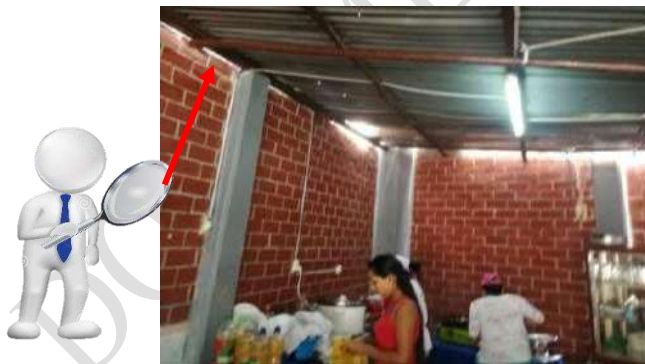
Figura N.º 10: Edificación sin viga de confinamiento
