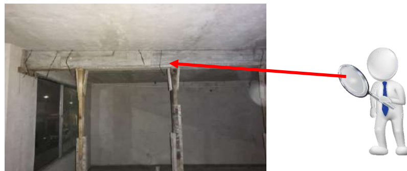
Figura N.º 48: Viga de concreto presenta pandeo
