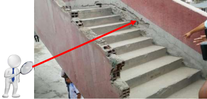
Figura N.º 59: Escalera de concreto presenta grietas
