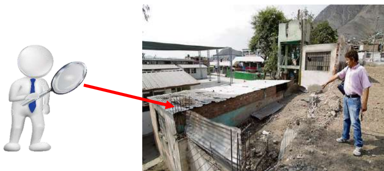
Figura N.º 47: Columna presenta varillas de acero expuestas a la intemperie sin recubrimiento
