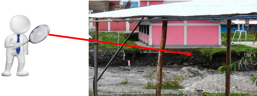
Figura N.º 41: Cimentación expuesta por socavamiento
