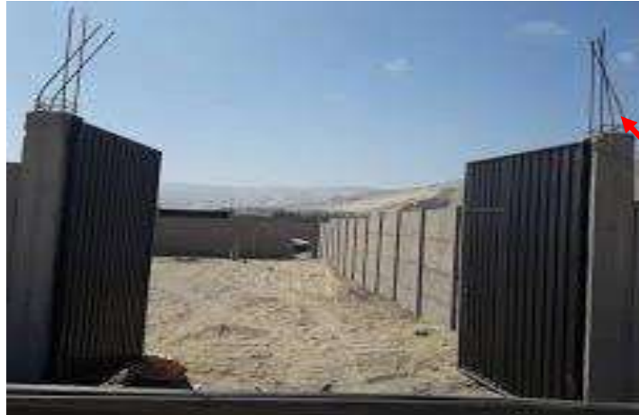
Figura N.º 95 : Cerco perimétrico de concreto con varillas de acero expuestas
