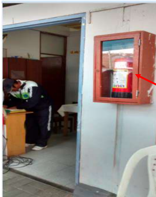
Figura N.º 222: Extintor instalado a la intemperie, colocado dentro de gabinete
