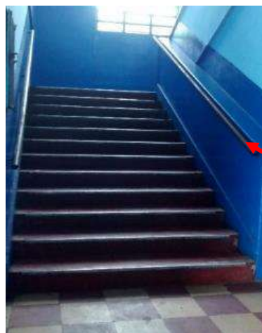
Figura N.º 112 : Escalera con pasamanos a ambos lados
