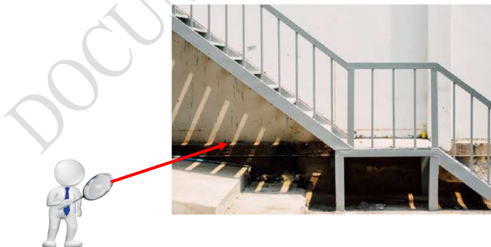
Figura N.º 126: Escalera libre de material combustible o inflamable
