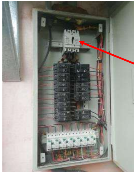
Figura N.º 196: Interruptor general en su interior
