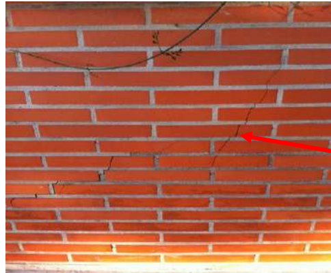
Figura N.º 63: Muro de ladrillo presenta daños por fisuras
