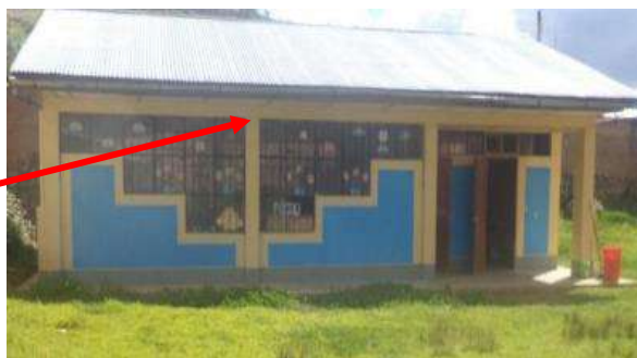
Figura N.º 62: Albañilería confinada con cemento, columnas y vigas sin losa de techo
