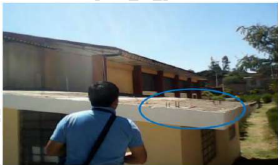
Figura N.º 53: Techo presenta mechas de acero expuestas a la intemperie
