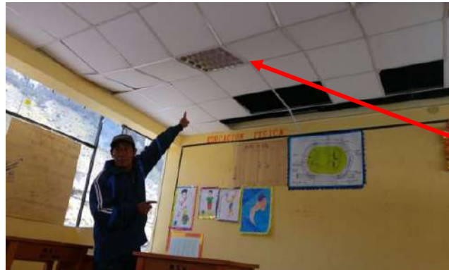
Figura N.º 144: Cielo raso o falso techo de aula requiere reparación
