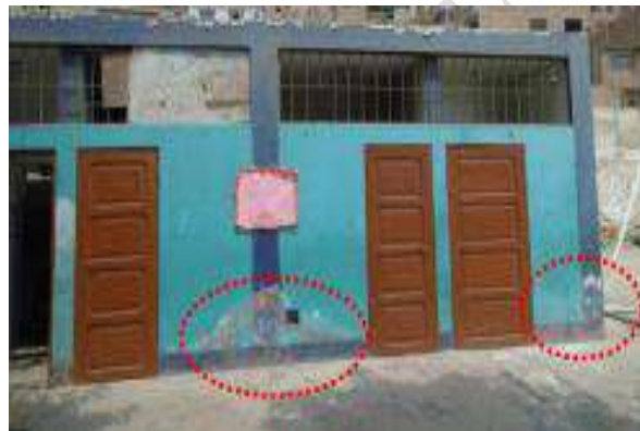
Figura N.º 67: Presencia de afloramiento de sales en el concreto de recubrimiento
