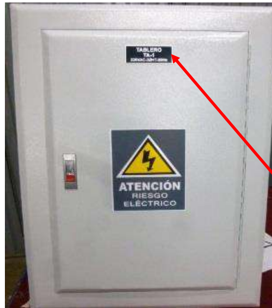
Figura N.º 204: Tablero eléctrico con identificación
