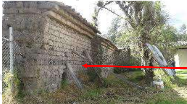
Figura N.º 72: Muro de adobe presenta daños por inclinación
