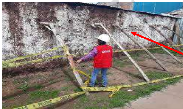
Figura N.º 106: Cerco `perimétrico de adobe presenta daños por inclinaciones
