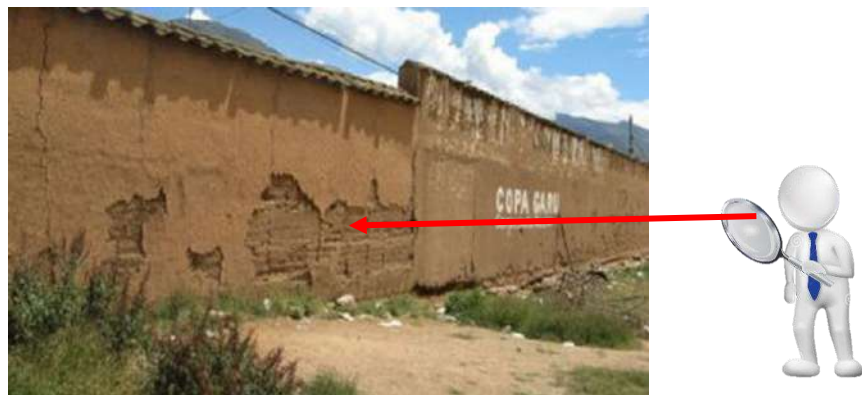
Figura N.º 104: Cerco perimétrico de adobe presenta daños
