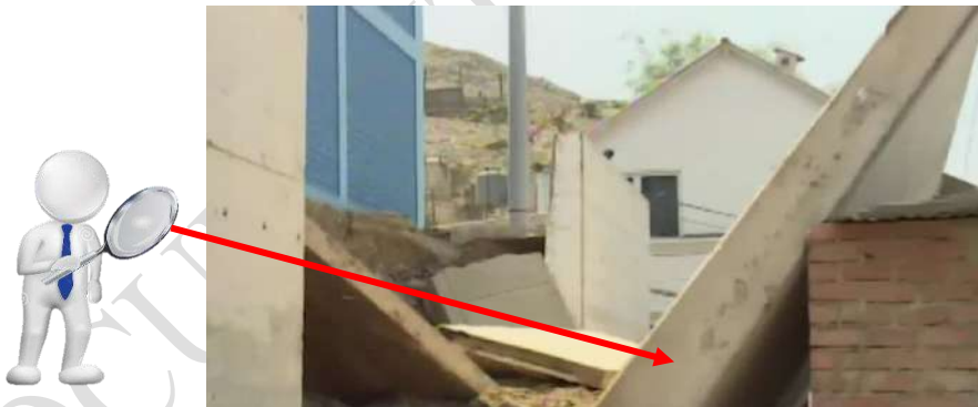
Figura N.º 58: Muro de contención colapso y pone en riesgo el local educativo
