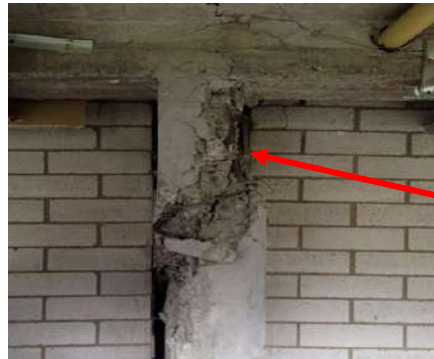
Figura N.º 30: Columna fracturada
