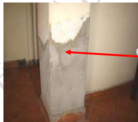
Figura N.º 44: Columna de concreto presenta deterioro por humedad
