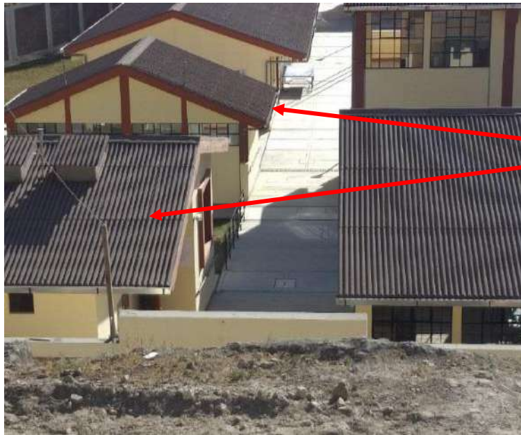
Figura N.º 181: Techo presenta cubierta inclinada y se compone de un sistema de evacuación de aguas pluviales
