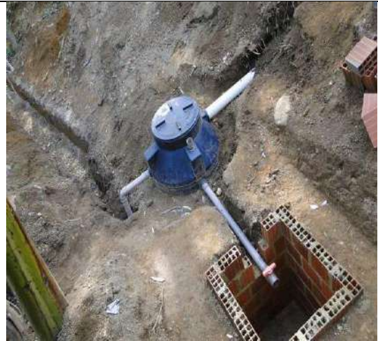
Figura N.º 171: Biodigestor y caja de lodos
