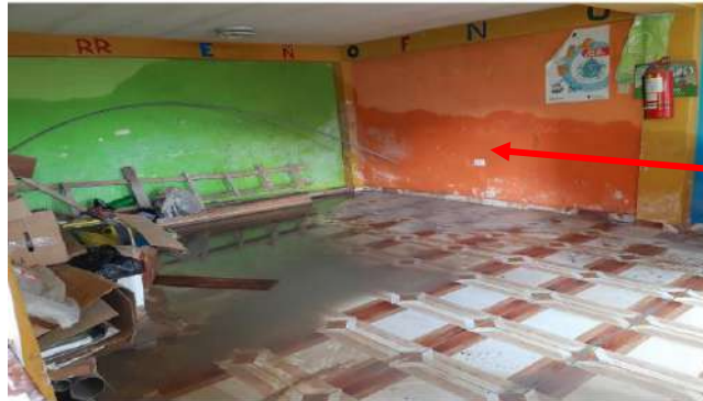
Figura N.º 66: Muro de ladrillo presenta daños por humedad
