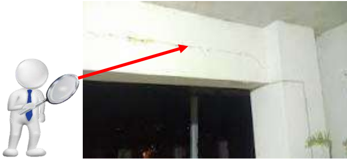
Figura N.º 45: Viga de concreto presenta fisuras
