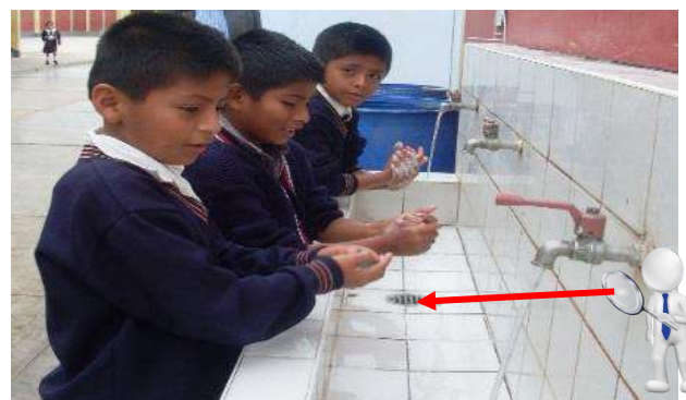
Figura N.º 185: Sumidero en lavadero
