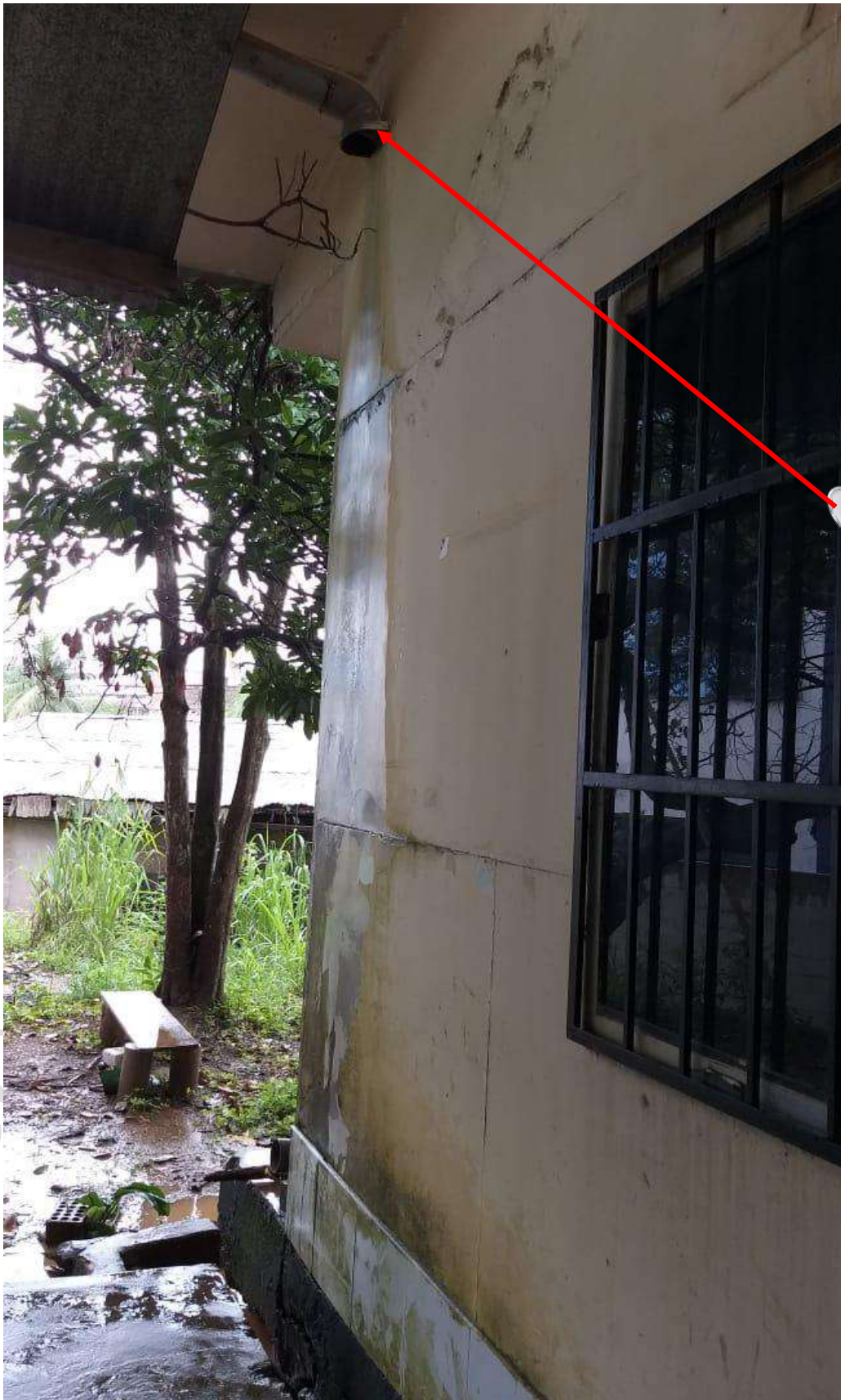
Figura N.º 180: Desfogue de agua de lluvia no esta conectado a red pública
