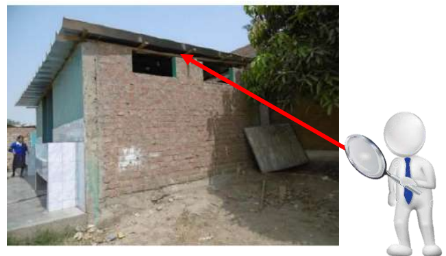
Figura N.º 11: Edificación sin viga de confinamiento
