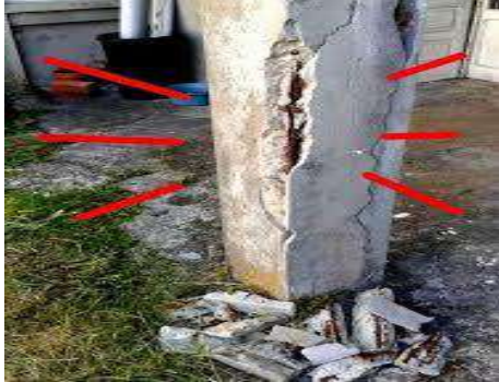
Figura N.º 29: Columna fracturada
