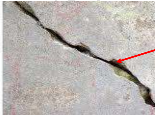
Figura N.º 56: Muro de concreto con grieta
