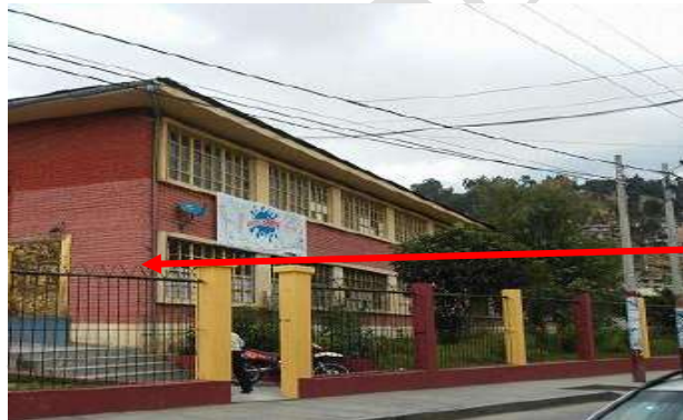
Figura N.º 109: Cerco perimétrico presenta elementos punzocortantes
