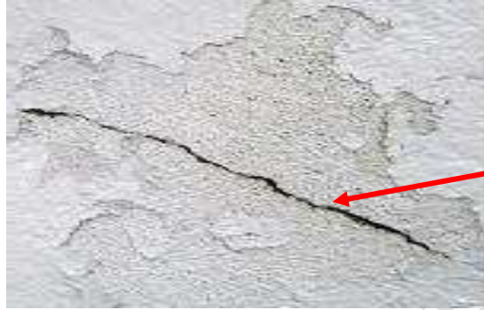
Figura N.º 55: Muro de concreto con fisura
