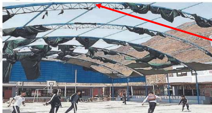
Figura N.º 81: Estructuras metálicas de mallas en áreas exteriores presentan óxido
