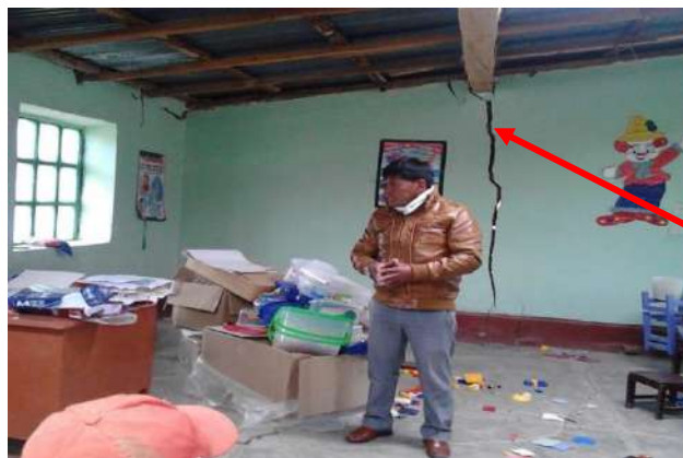
Figura N.º 70: Muros con grietas
