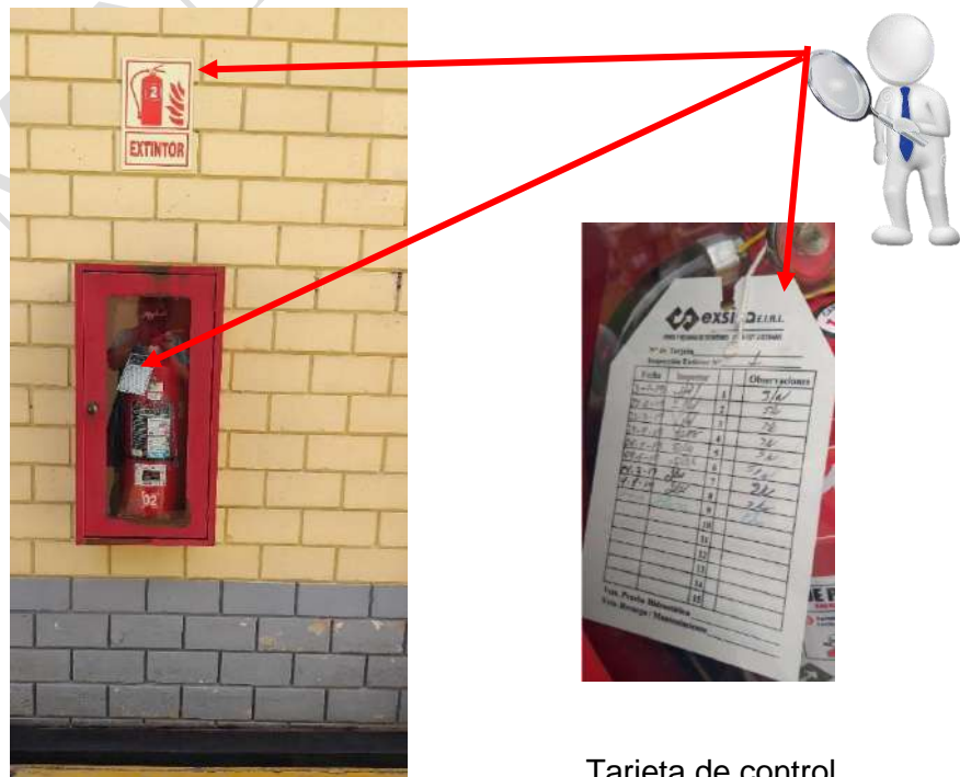
Figura N.º 221: Extintor con tarjeta de control a una altura no mayor de 1.50 m, numerado ubicado en lugar accesible
