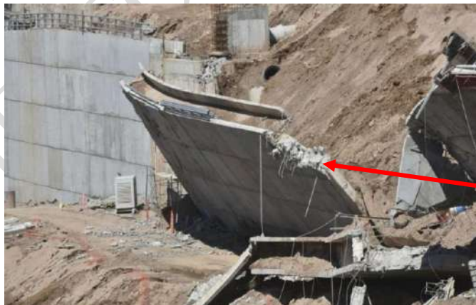
Figura N.º 94 : Cerco perimétrico de concreto presenta daños por inclinación
