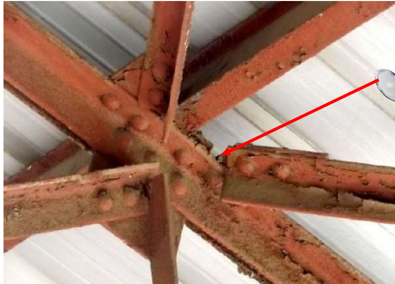
Figura N.º 78: Desprendimiento de nudo de estructura metálica
