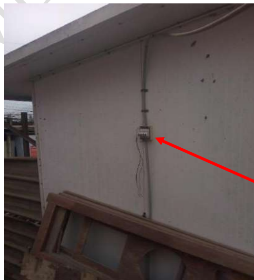
Figura N.º 215: Módulo educativo con interruptor termomagnético expuesto
