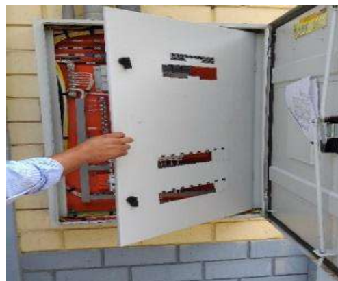
Figura N.º 206: tablero eléctrico con placa de protección mandil abierta
