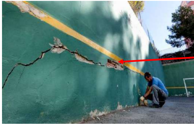
Figura N.º 97 : Cerco perimétrico de ladrillo presenta daños por grietas
