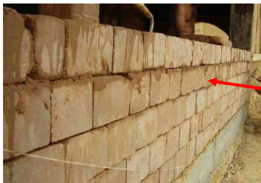
Figura N.º 65: Muro de ladrillo presenta daños por inclinaciones
