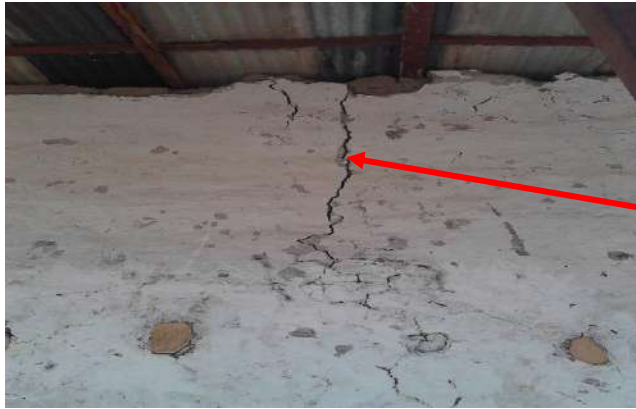
Figura N.º 71: Muro de adobe presenta daños por fisuras
