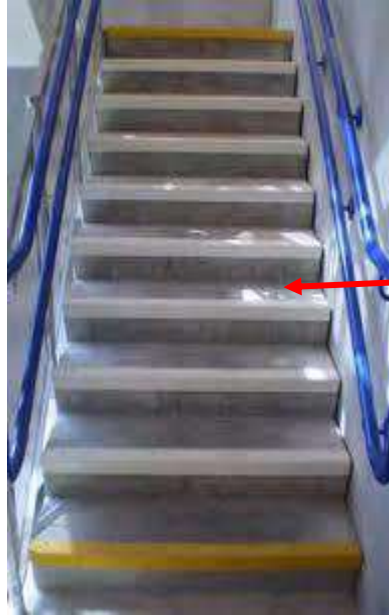
Figura N.º 115 : Escalera con piso antideslizante
