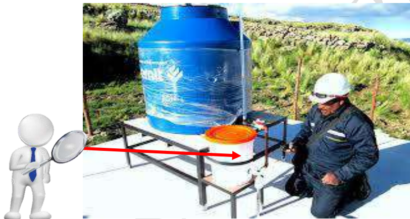
Figura N.º 166: Cloración de agua
