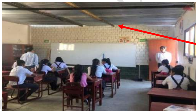
Figura N.º 61: Aula con muro de ladrillo sin vigas de confinamiento
