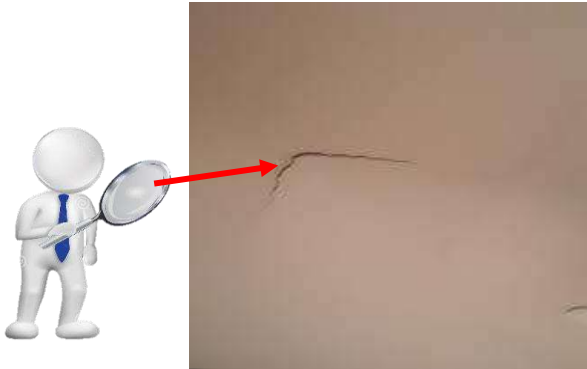
Figura N.º 51: Techo de concreto presenta fisuras
