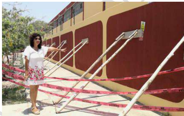
Figura N.º 98 : Cerco perimétrico de ladrillo presenta daños por inclinaciones
