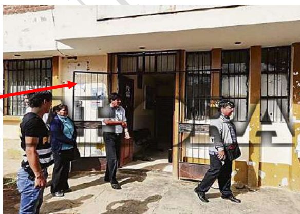
Figura N.º 124: Aula de cómputo con puerta de madera y reja de seguridad
