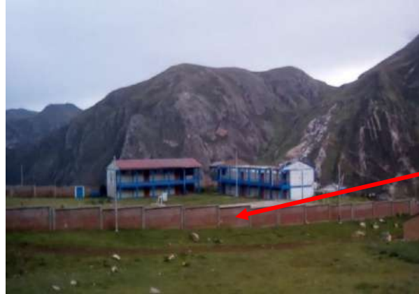
Figura N.º 100: Cerco perimétrico de ladrillo presenta daños por humedad
