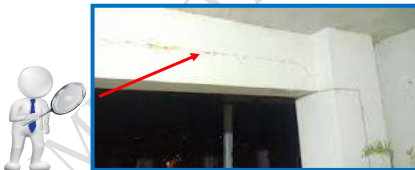
Figura N.º 22: Techo con vigas agrietadas
