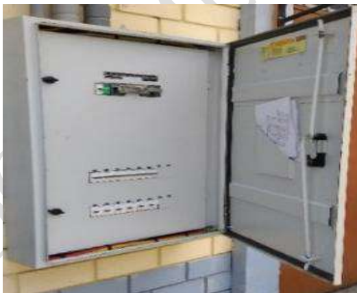
Figura N.º 205: tablero eléctrico con placa de protección mandil
