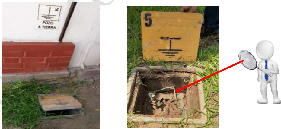
Figura N.º 212: Pozo a tierra con varilla y conector
