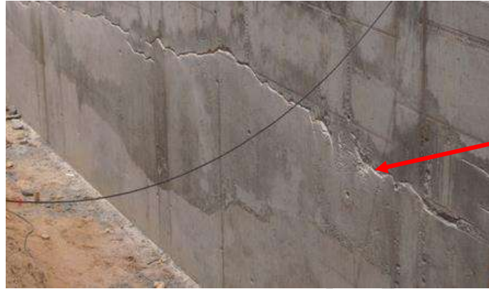
Figura N.º 93 : Cerco perimétrico de concreto presenta fisuras
