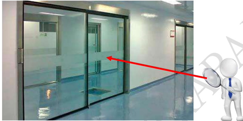
Figura N.º 132: Puerta de vidrio con banda señalizadora
