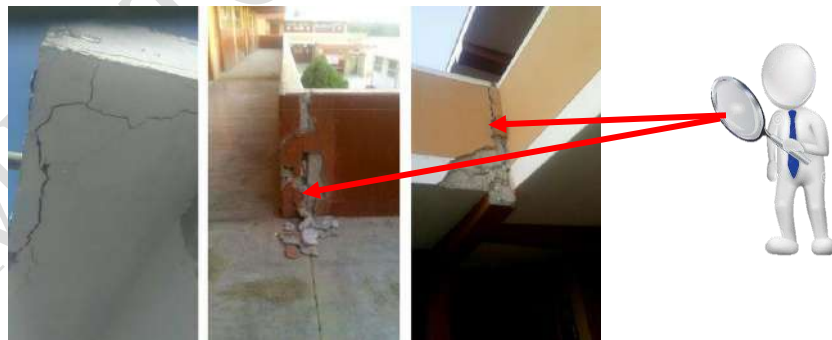
Figura N.º 69: Parapeto presenta grietas
