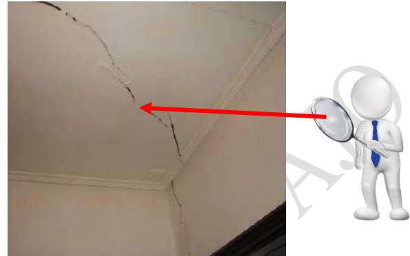
Figura N.º 52: Techo de concreto presenta grietas
