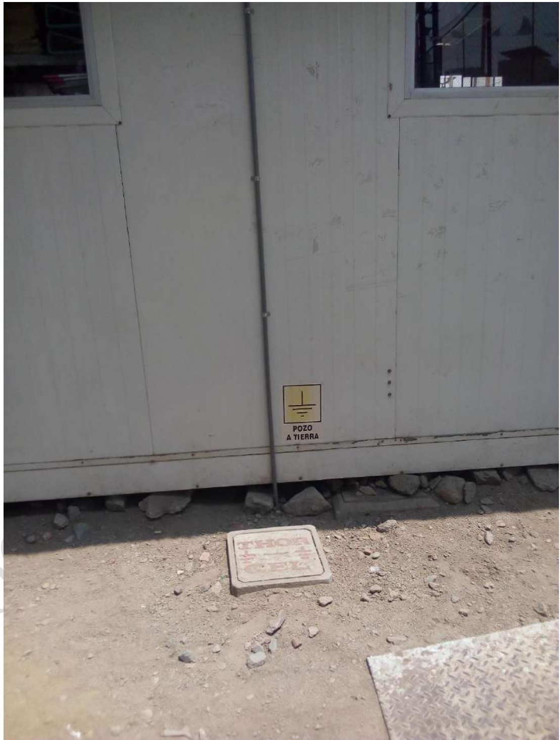
Figura N.º 216: Módulo educativo con conexión al sistema de puesta a tierra
