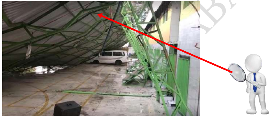
Figura N.º 75: Techo de estructura metàlica en àreas exteriores colapsado
