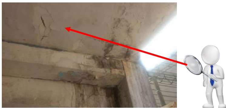
Figura N.º 54: Techo presenta daños por pandeo
