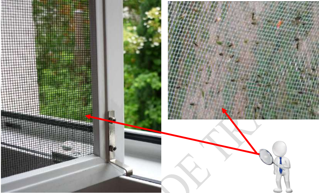
Figura N.º 125 : Malla mosquitero en ventana:
