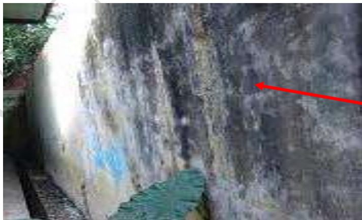
Figura N.º 96 : Cerco perimétrico de concreto presenta deterioro por humedad
