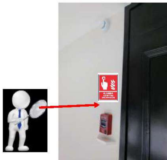
Figura N.º 218: Alarma contra incendios ubicado al inicio de la salida
