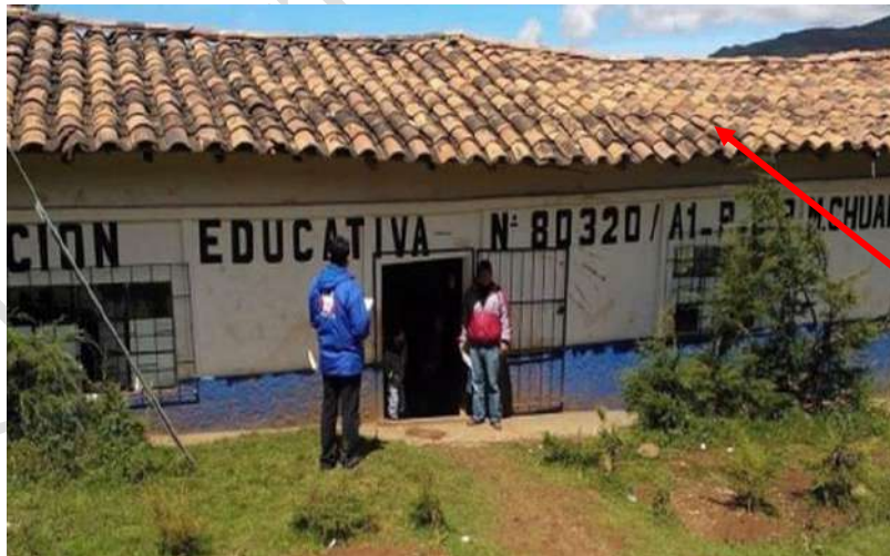
Figura N.º 138: Cobertura ligera es tejas de arcilla y presenta deterioro
