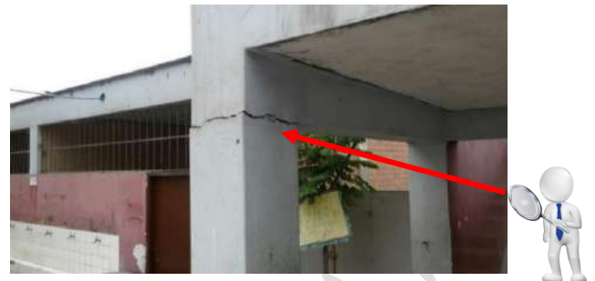
Figura N.º 46: columna de concreto presenta grietas.
