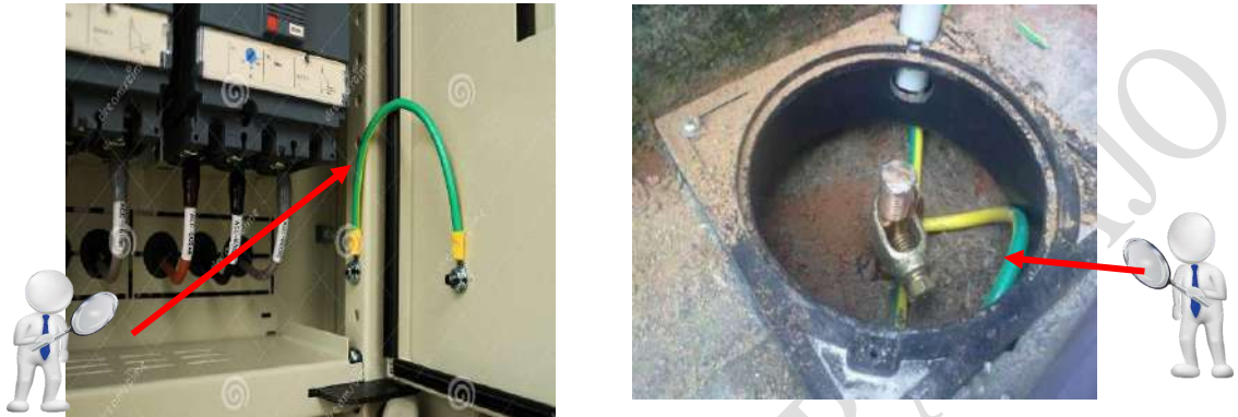
Figura N.º 211: Tablero eléctrico con sistema de puesta a tierra
