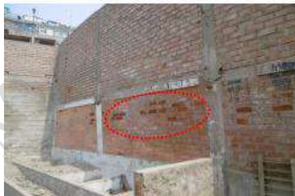
Figura N.º 101: Cerco perimétrico de ladrillo presenta daños por degradación de ladrillos
